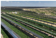
孟家湾光伏项目
